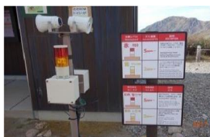
(火山ガス監視小屋と警報機)
